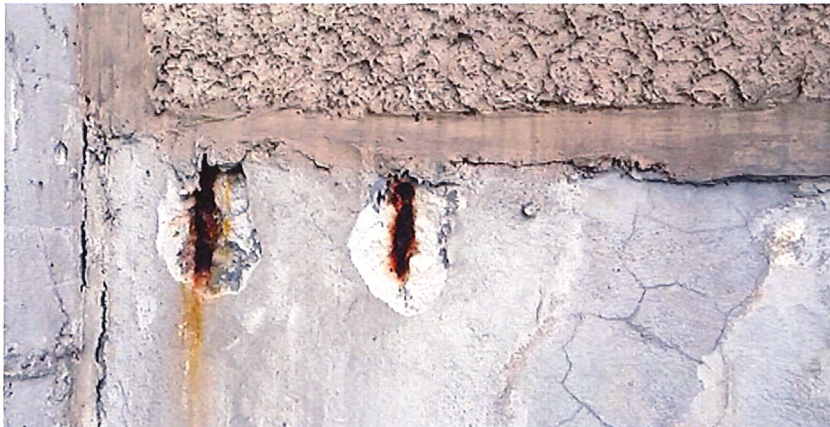
Betonabplatzungen / rostige Eisen
